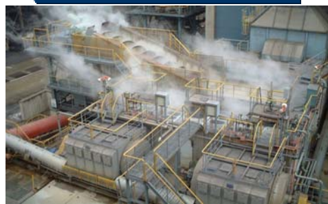
水砕スラグ製造設備
